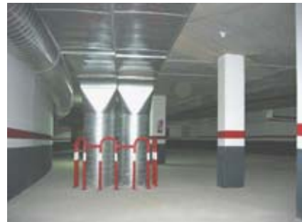
Ventilación forzada Garajes
